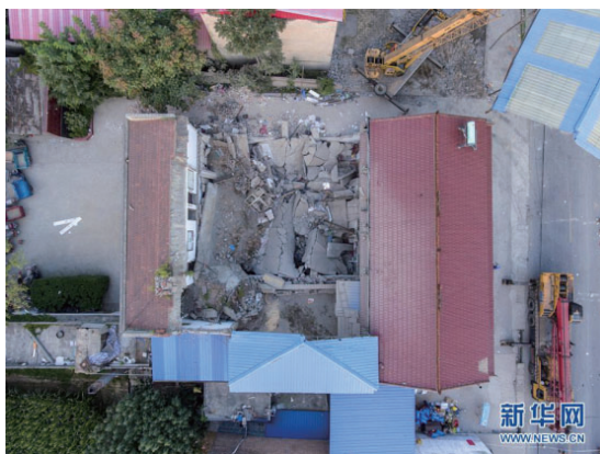
■ 图片来自中新网：8月29日拍摄的事故救援现场（无人机照片）
