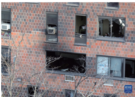
■ 图片来自新华网：1月10日在美国纽约市布朗克斯区拍摄的发生火灾的公寓楼
